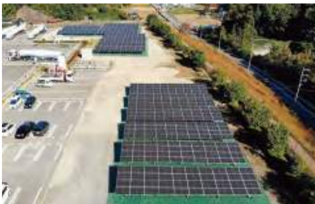
備後工場太陽光発電設備
