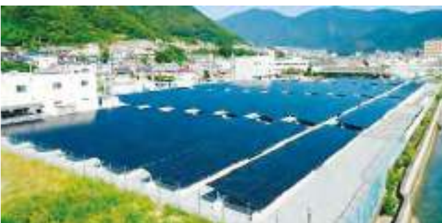
阿賀太陽光発電所
