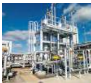
備後工場LNG気化器
