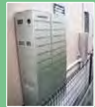
厨房・給湯など
