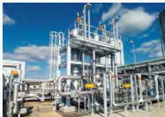
備後工場 LNG気化器
