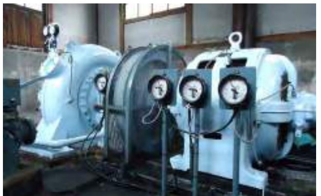
水車および発電機
