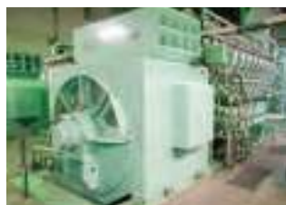
ガスコージェネレーションシステム (廿日市工場)
